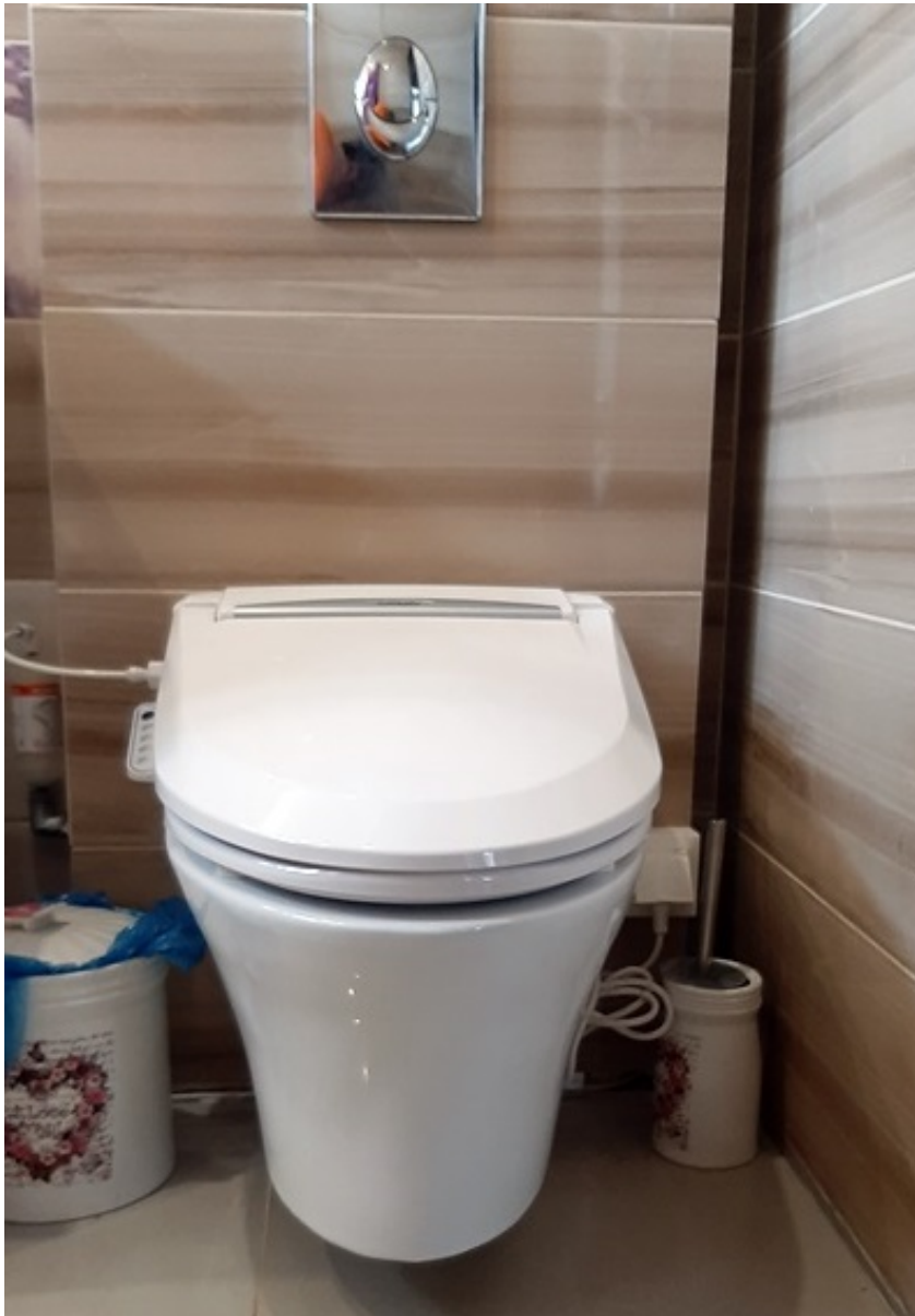
Łazienka z zainstalowaną elektroniczną deską myjącą XARAM Energy Q-7700
